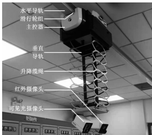
图 1 吊轨式智能巡检机器人
