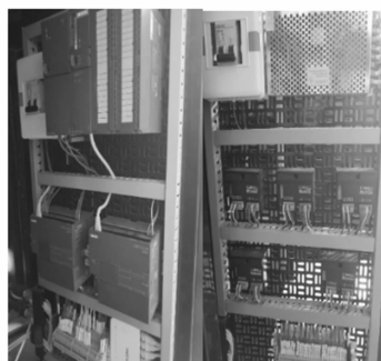
图 13 PLC 驱动控制柜
