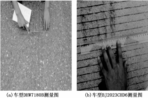
图 3 痕迹宽度现场测量图
