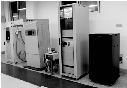
图 2 电动汽车充电桩自动检测系统实物图
