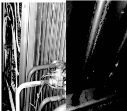
图 2 蒸发器结霜及表冷挡水板结冰情况
